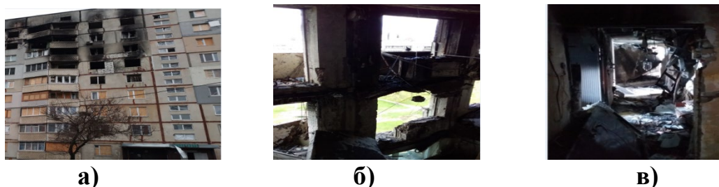
Рисунок 4– Пошкоджені конструкції об'єкту:
